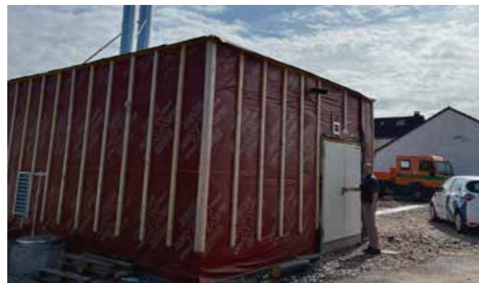
Am Rande des Baugebietes befindet sich das Blockheizkraftwerk, das von den Stadtwerken Menden betrieben wird
